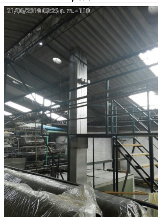
Fotografía N°. 4 Ducto horno, puertos de muestreo y plataforma
